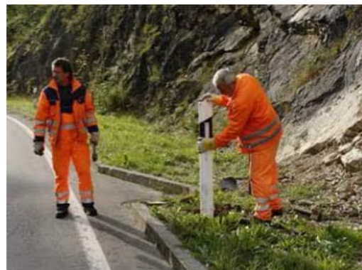
Austausch eines beschädigten Leitpfostens © Staatsbauverwaltung
