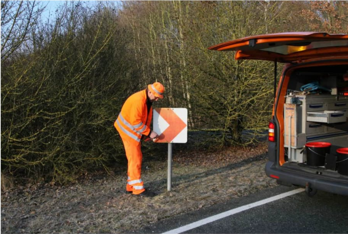
Absichern einer Gefahrenstelle © Staatsbauverwaltung
